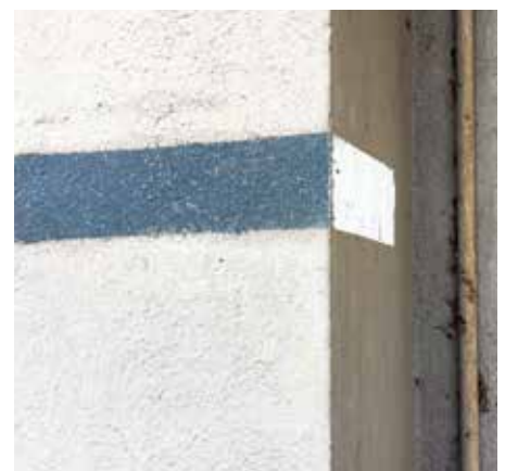
Alte Farbschichten am Gebäudesockel.
